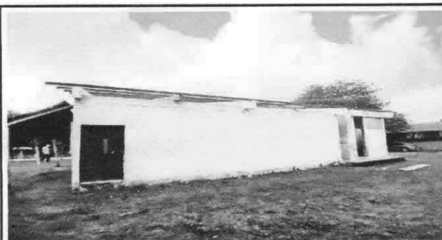
Foto 3: Sustrucción de elementos de fijación.
